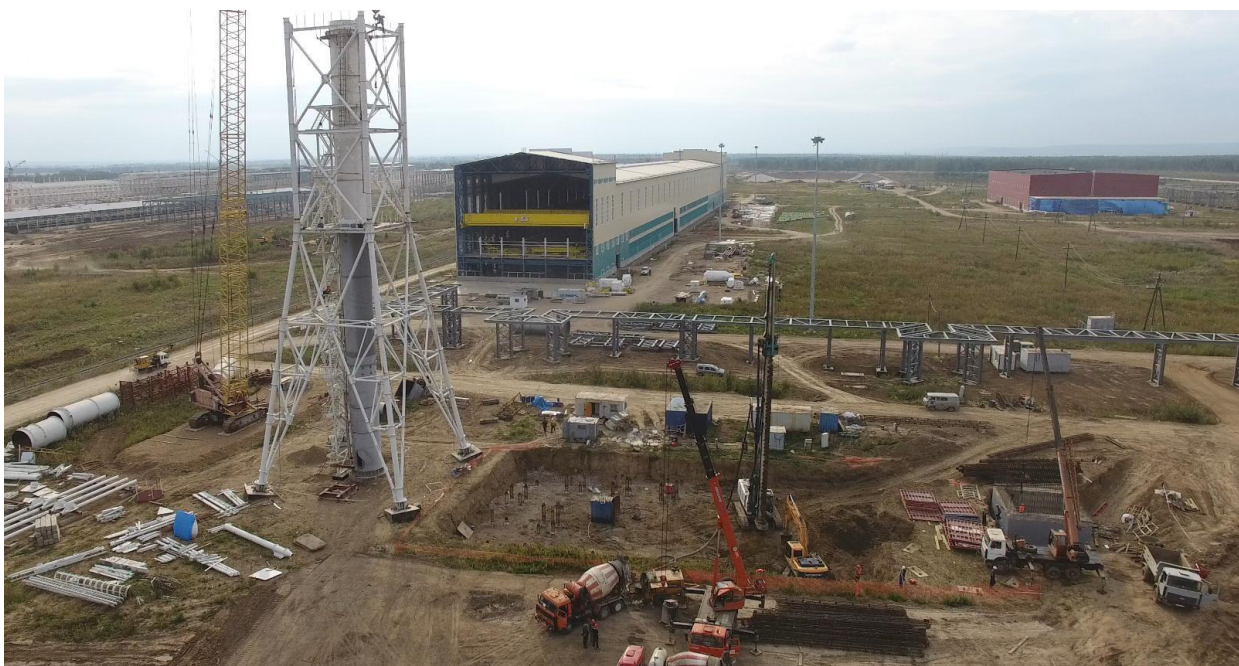
Рисунок 1.1-2. Реализация первого этапа строительства Тайшетской Анодной фабрики. Строительство газоочистной установки печей обжига анодов
