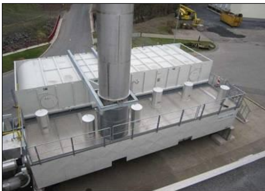
Рисунок 5.1.1.6-10. Газоочистная установка СПО: ALSTOM, SOLIOS (Франция)
