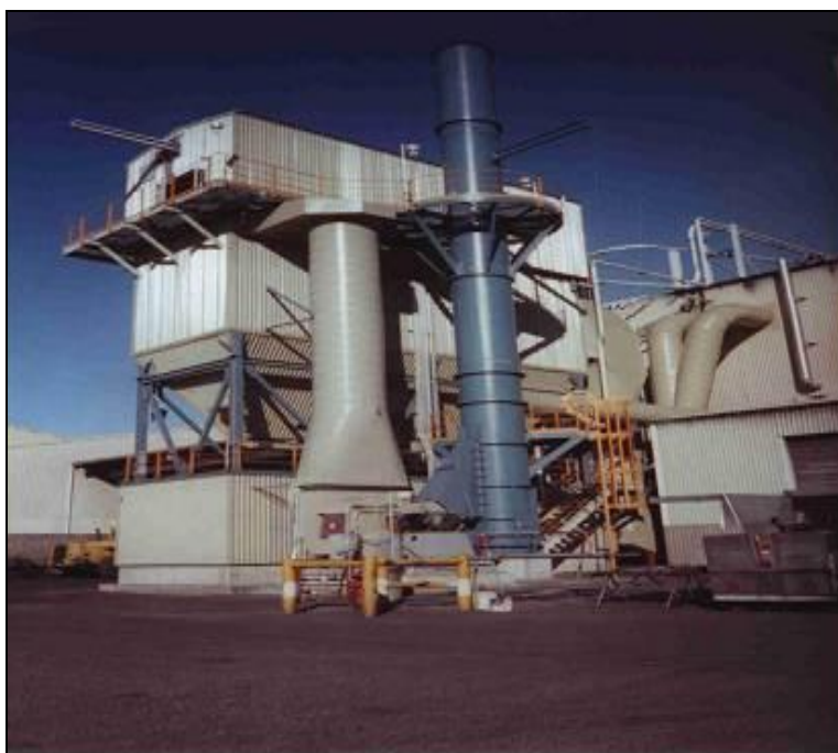
Рисунок 5.1.1.6-6. Установка регенеративного термического окисления (РТО)
